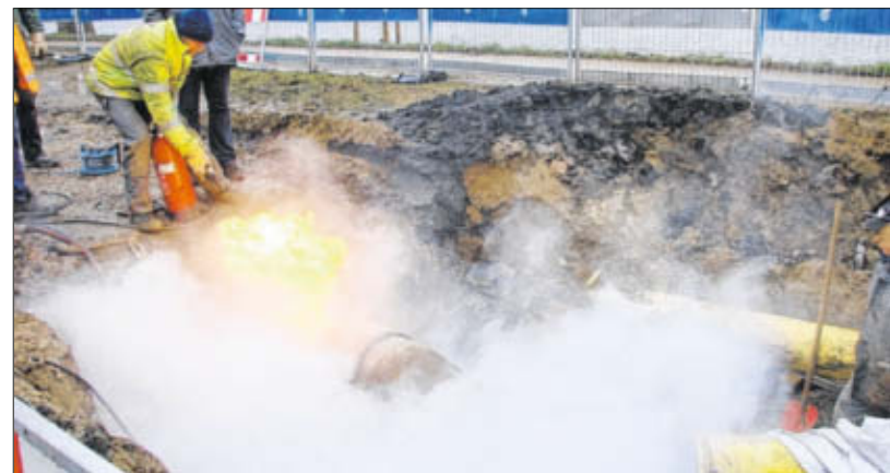
Erst mit einem Feuerlöscher gehen die Flammen aus. Fotos: Holger Kröger
